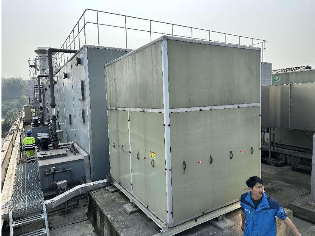
厨余垃圾分选+大件破碎车间废气处理设备照片（排气筒、化学洗涤塔、生物除臭装置、离心风机）
