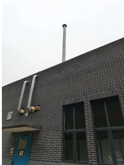
图 4.1.11 锅炉设施排气筒现场照片
