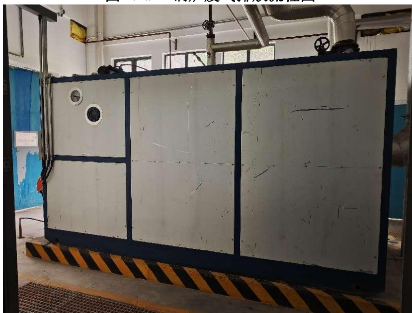
图 4.1.10 锅炉设施现场照片
