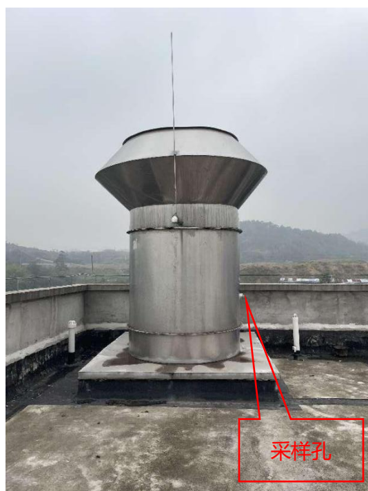
图 4.1.20 餐厨转运车间排气筒及采样口
