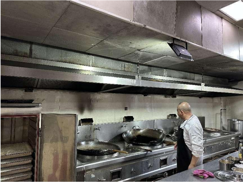
图 4.1.13 食堂油烟净化器现场照片
