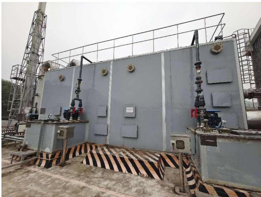
图 4.1.7 污水处理站废气处理设施现场照片
