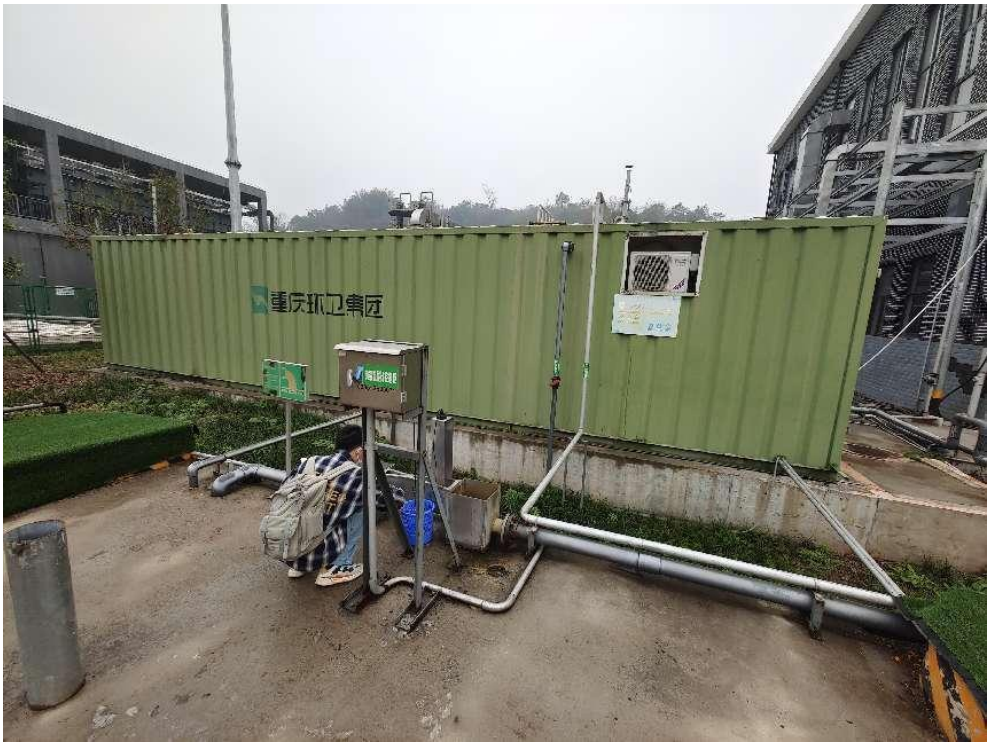
图 4.1.17 生活污水一体化处理设施及排放口现场照片
