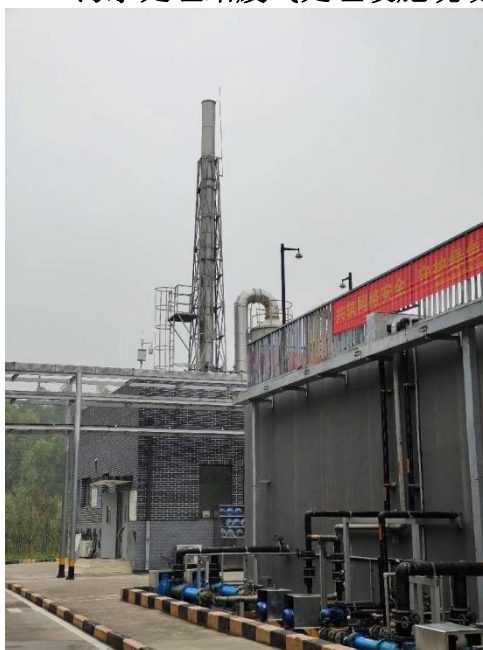
图 4.1.8 污水处理站废气处理设施排气筒现场照片
