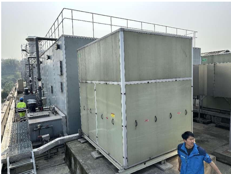
图 4.1.5 厨余垃圾分选+大件破碎车间废气处理设施现场照片
