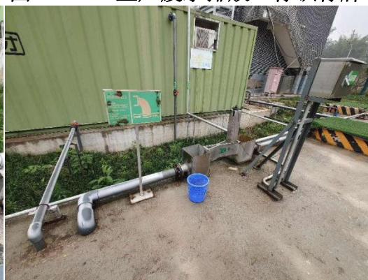
图 4.1.25 生活废水排放口标识标牌
