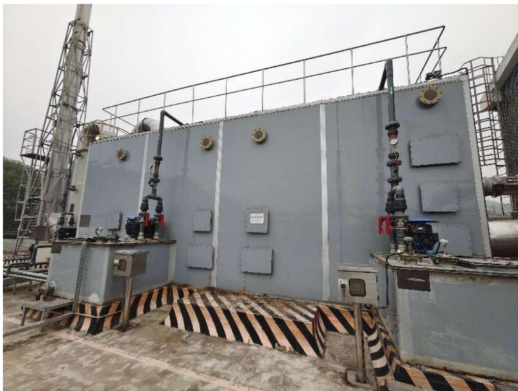
污水处理站废气处理设备（排气筒、化学洗涤设备、生物除臭装置）
