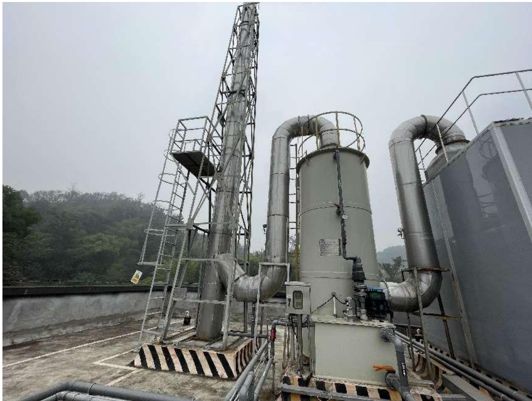
污水处理站废气处理设备（排气筒、化学洗涤设备）
